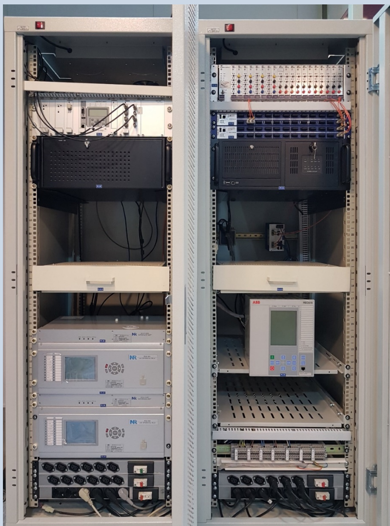
پایلوت ارتباط مخابراتی داخل پست DCS و بین پست DCS تا مرکز کنترل
